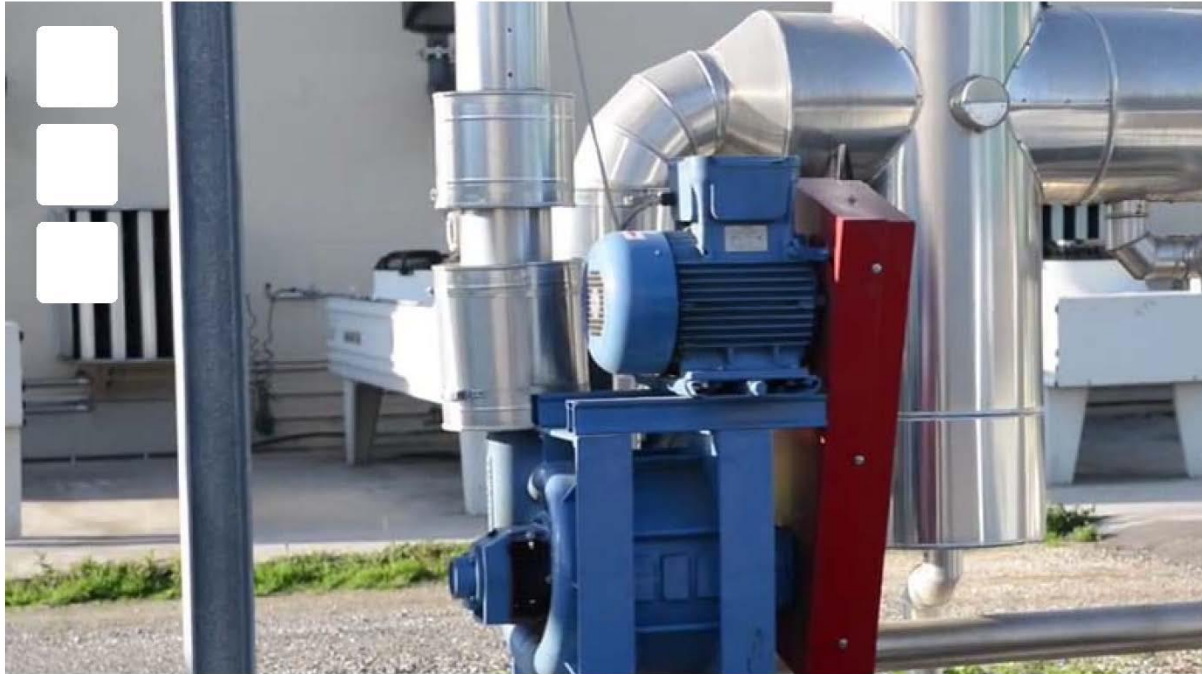
Figura 03 - VISTA FOTOGRAFICA DI UNA SOFFIANTE DEL SISTEMA DI "CLEANING BIOGAS"
