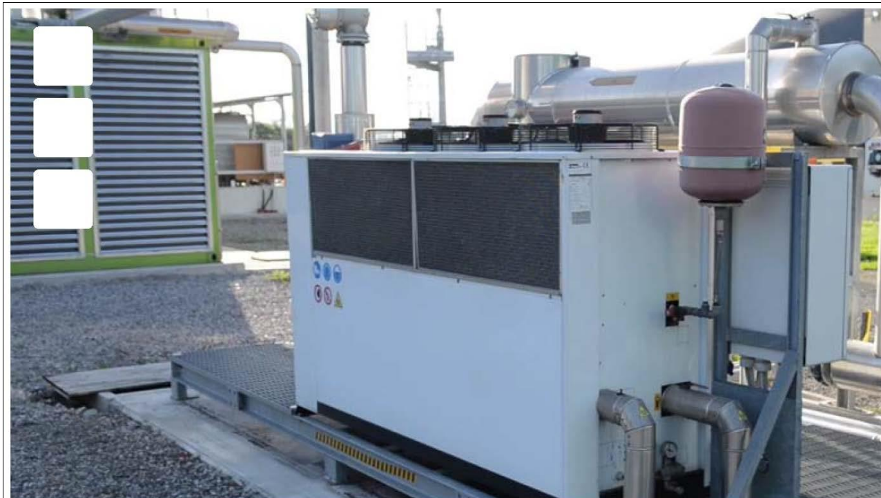
Figura 02 - VISTA FOTOGRAFICA DI UN CHILLER DEL SISTEMA DI "CLEANING BIOGAS"
