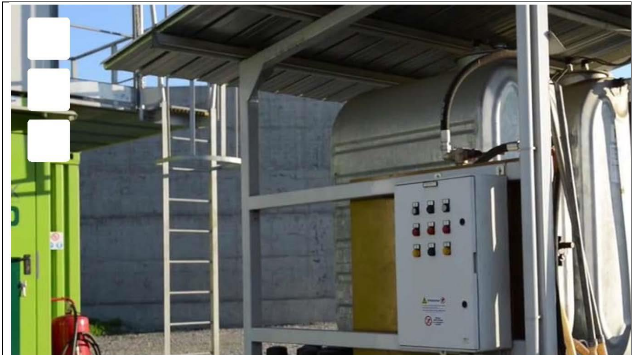
Figura 9 - VISTA DELLO "SKID OLIO TIPO"
