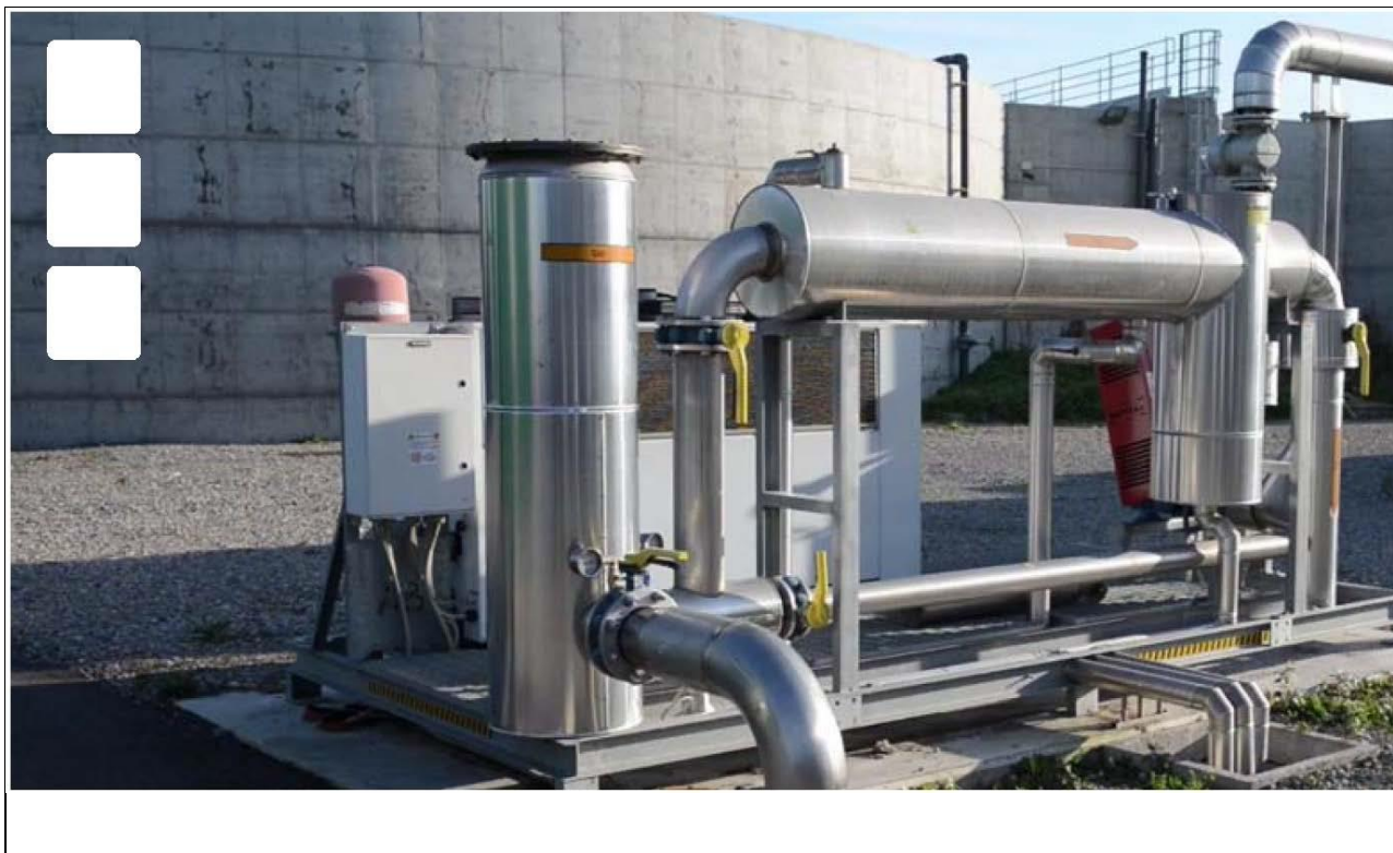
Figura 01 - VISTA FOTOGRAFICA DI UN SISTEMA DI "CLEANING BIOGAS"
